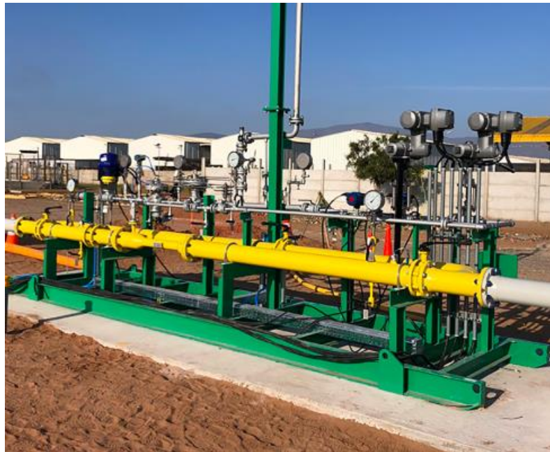
Figura 8. Blending skid instalado en la IV Región, Gas Valpo. Proveedor Pietro Fiorentini.
