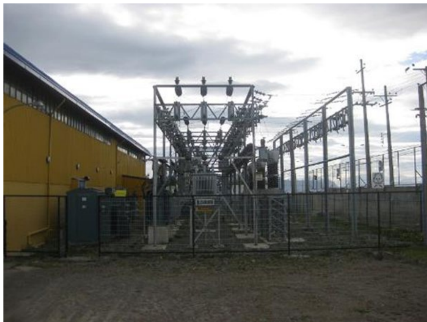
Figura 133. Subestación Puerto Natales
