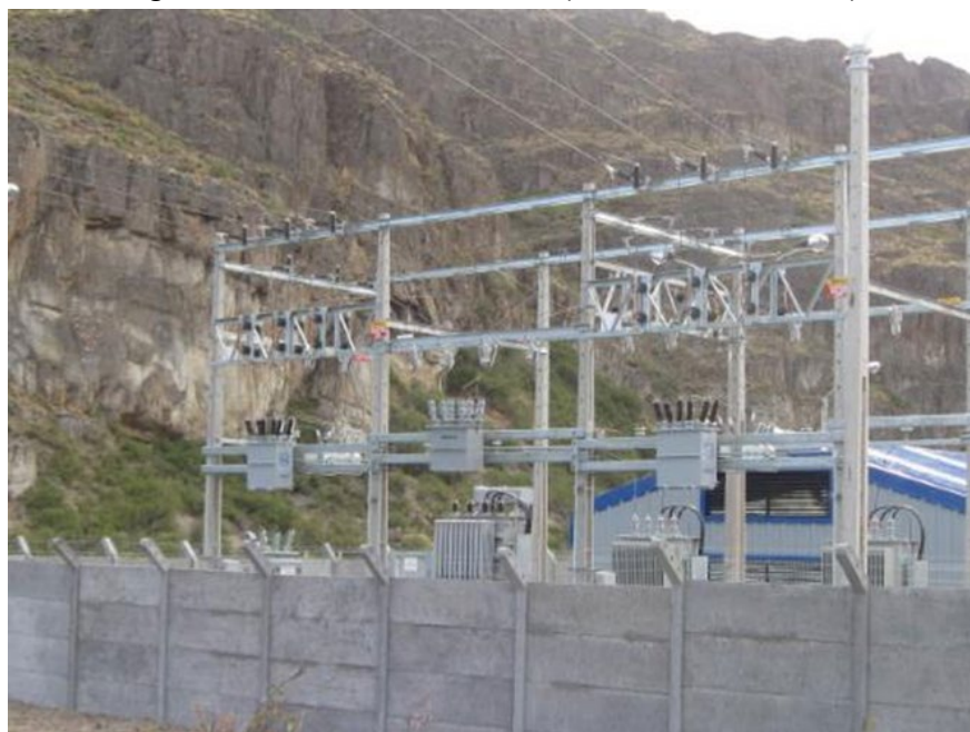
Figura 149. Subestación Chile Chico (SSMM General Carrera)
