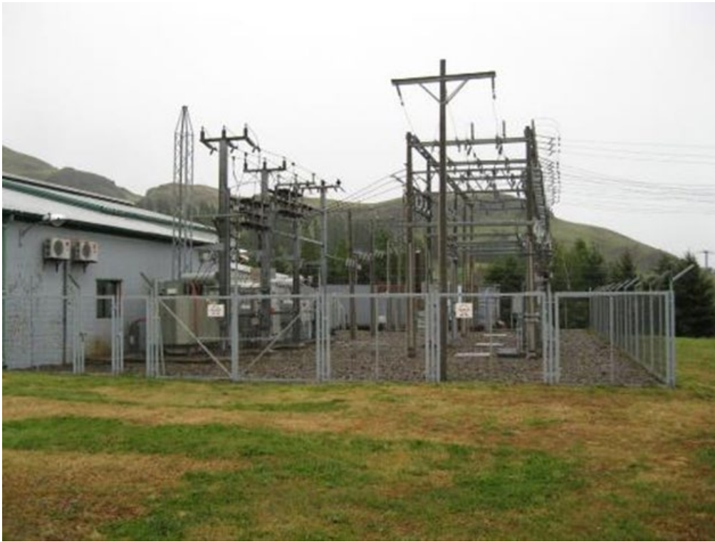
Figura 144. Subestación Tehuelche (SSMM Aysén)
