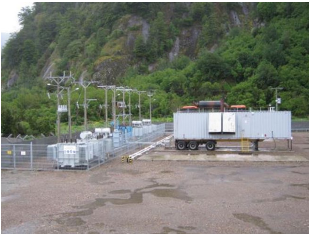
Figura 141. Subestación Chacabuco (SSMM Aysén)
