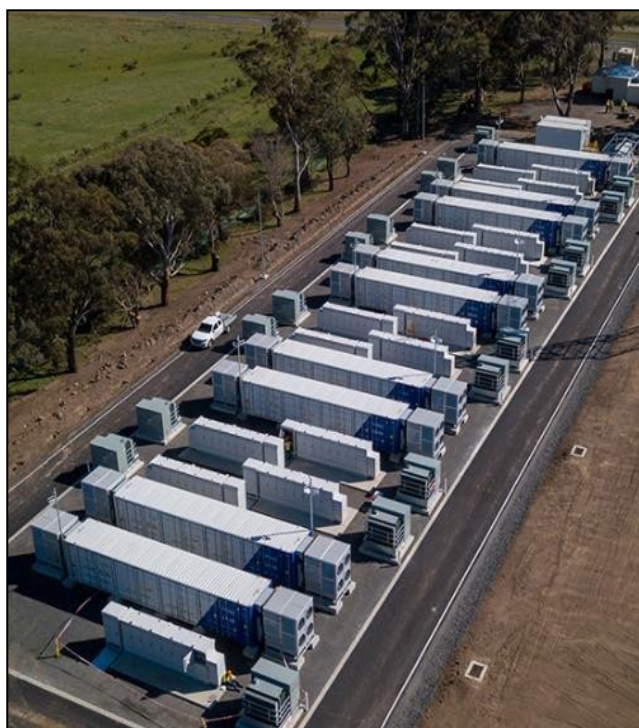
Figura 14. Sistema de Almacenamiento de energía mediante Baterías (BESS)
