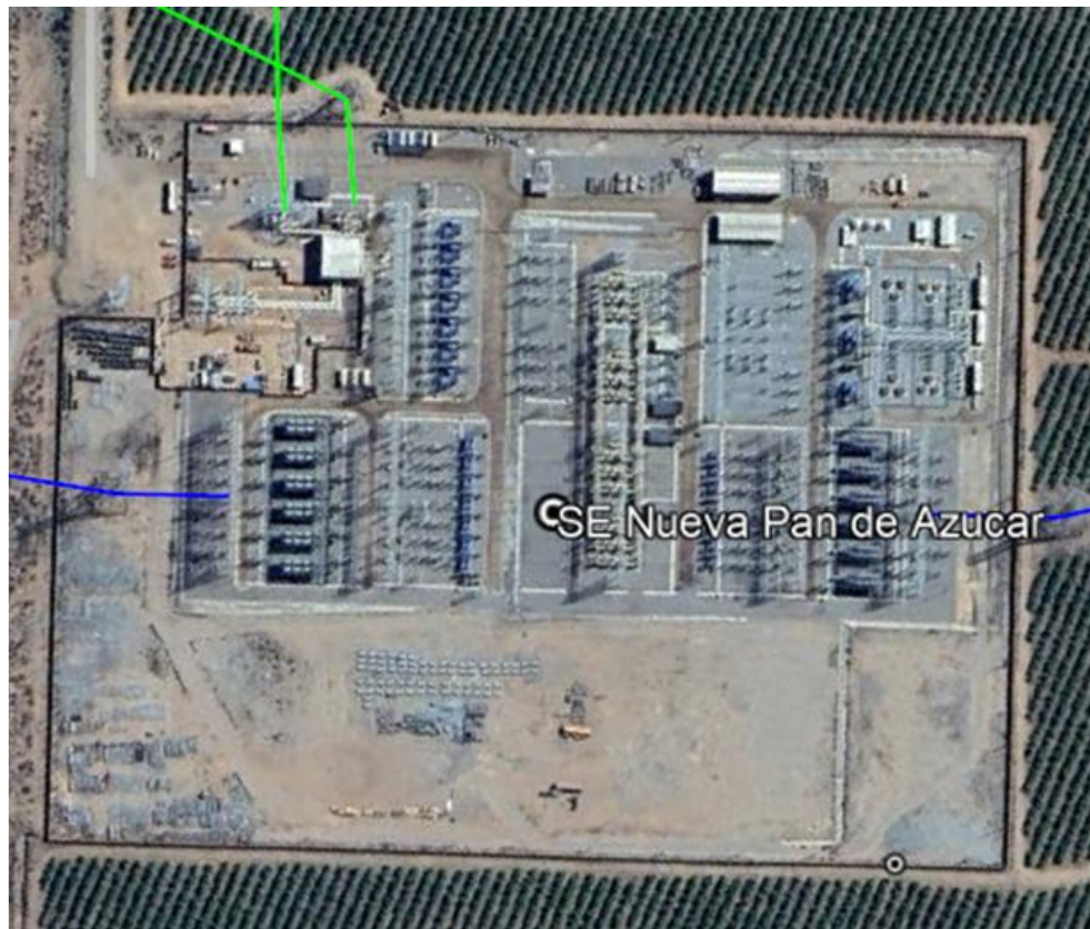
Figura 86: Subestación Nueva Pan de Azúcar 220 kV
