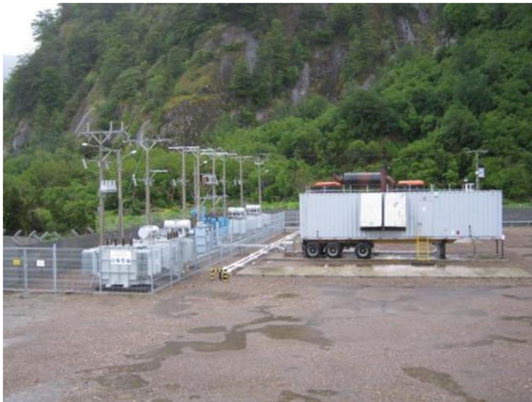
Figura 141: Subestación Chacabuco (SSMM Aysén)
