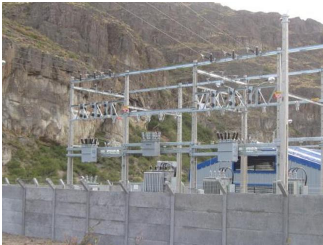
Figura 149: Subestación Chile Chico (SSMM General Carrera)
