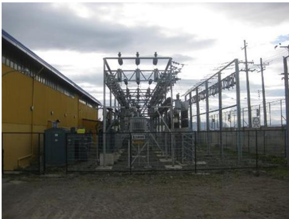
Figura 133: Subestación Puerto Natales
