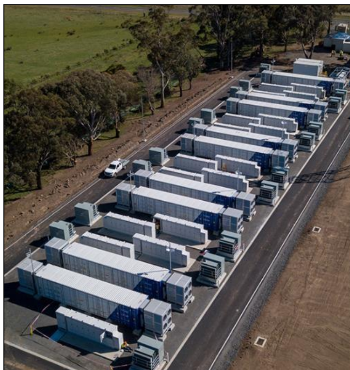
Figura 14 Sistema de Almacenamiento de energía mediante Baterías (BESS)
