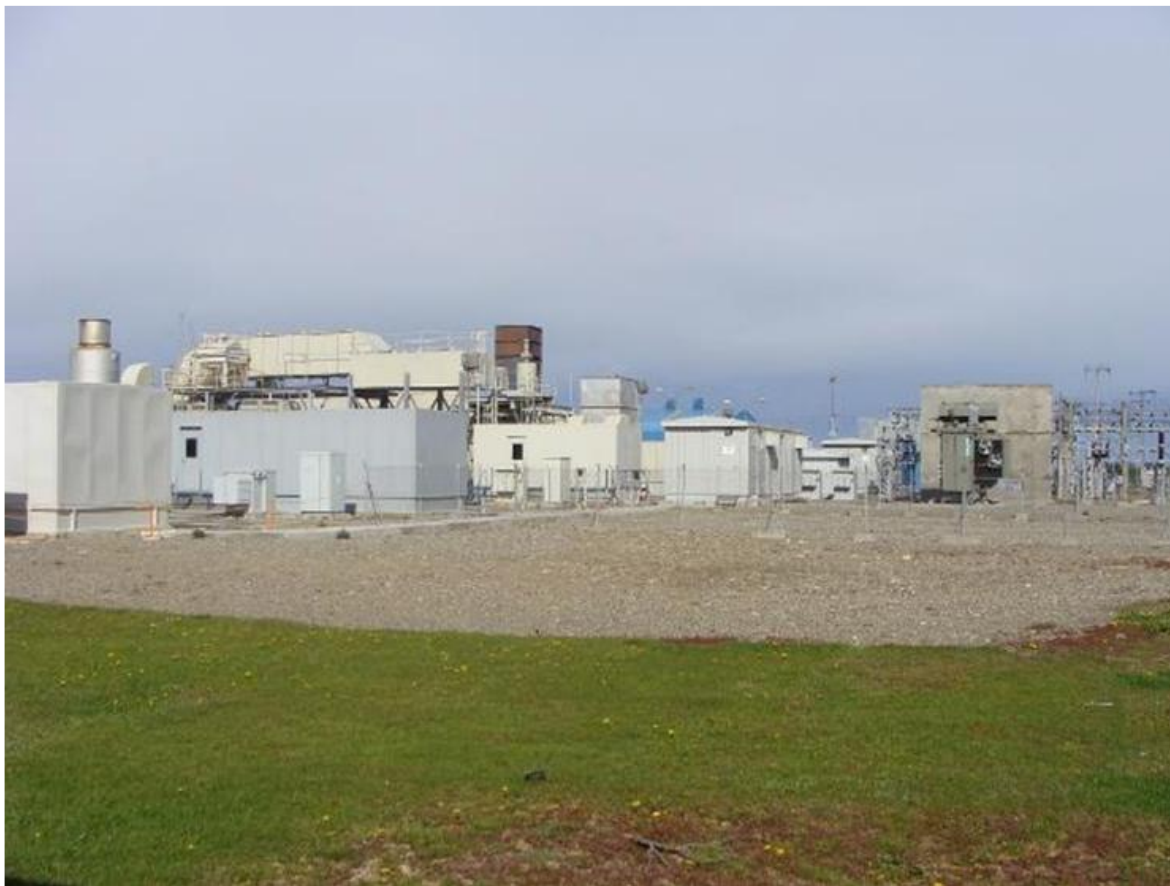
Figura 130: Subestación Tres Puentes
