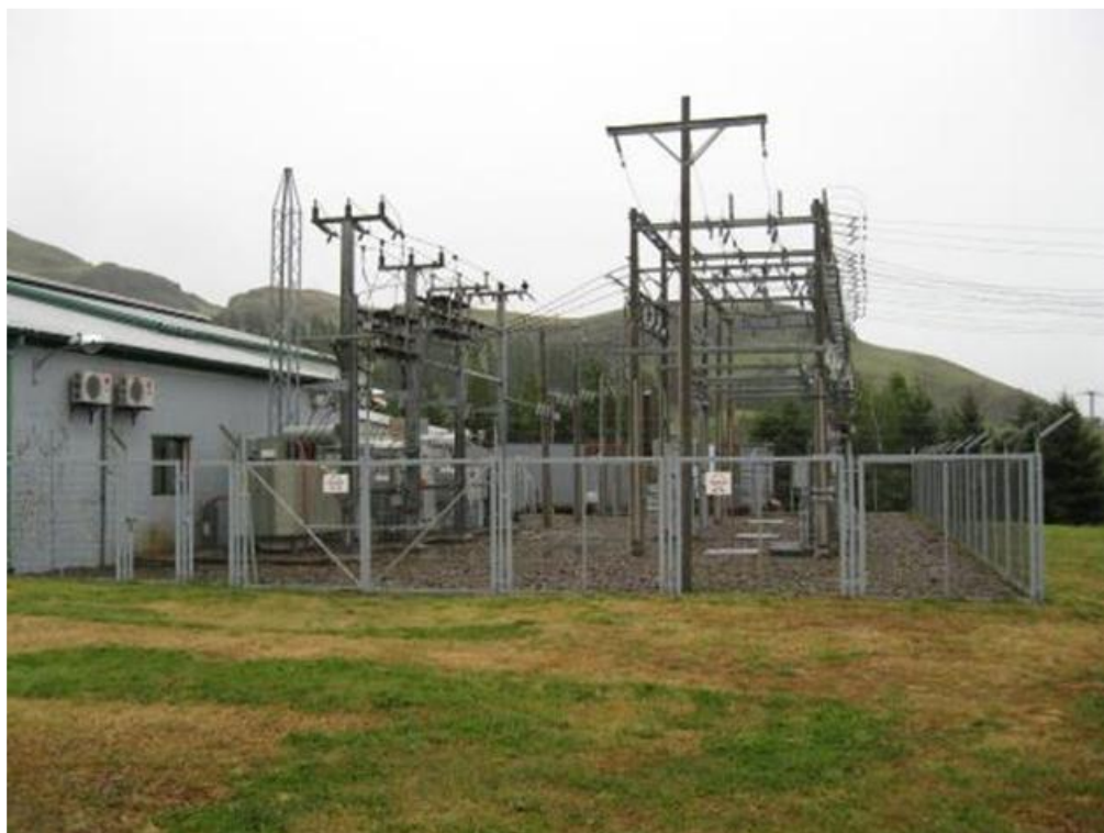
Figura 144: Subestación Tehuelche (SSMM Aysén)
