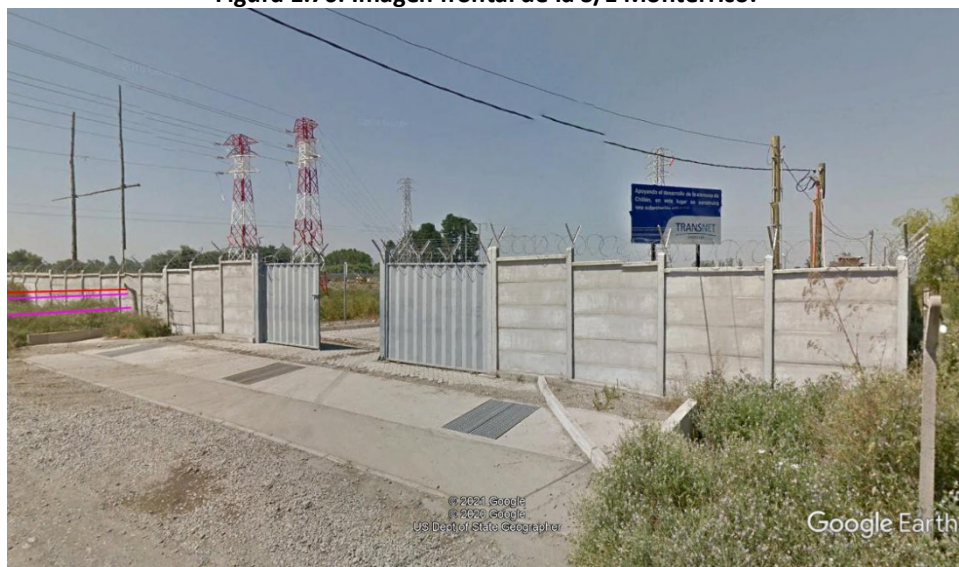
Figura 1.76: Imagen frontal de la S/E Monterrico.
