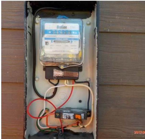
Medidor a ser reemplazado.
