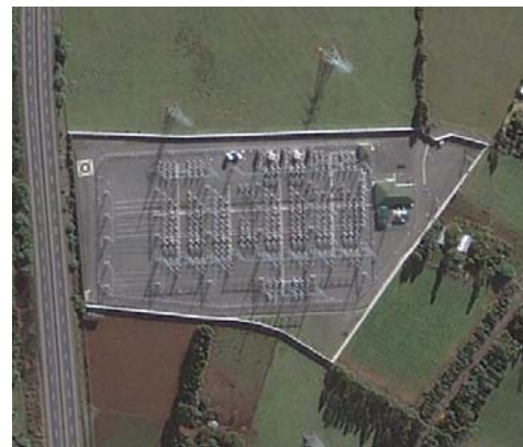
Subestación Cautín 500 kV
