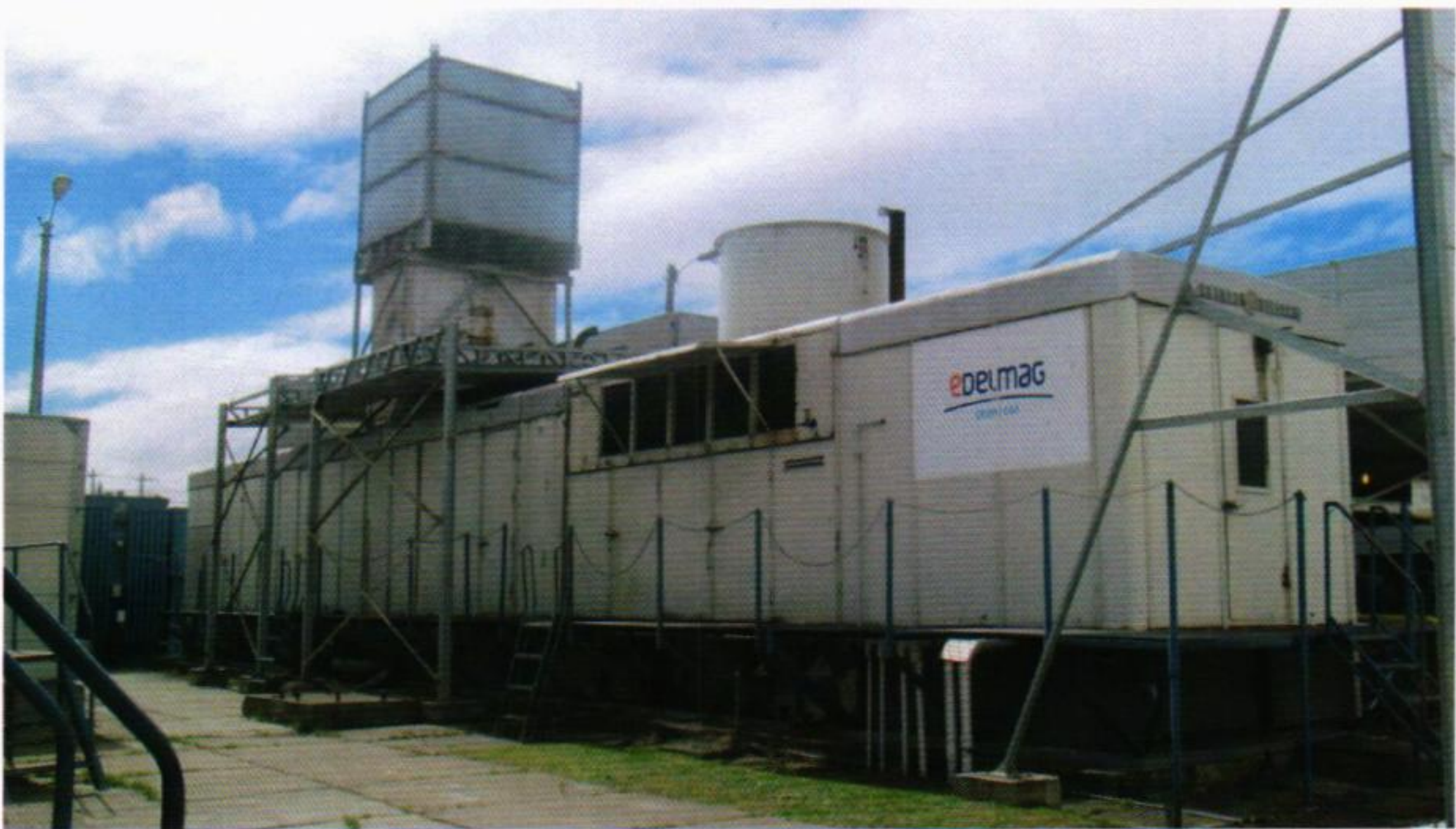
Figura 4: Turbina GE N°4, elementos periféricos y silenciador del escape con panel insonorización.
