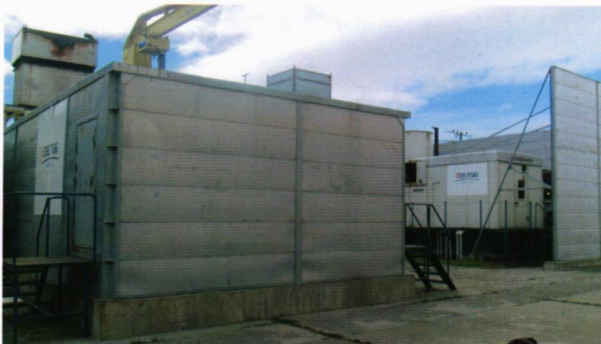
Figura 2: Turbinas GE N°5 y GE N°4, con sus respectivos paneles de insonorización.
