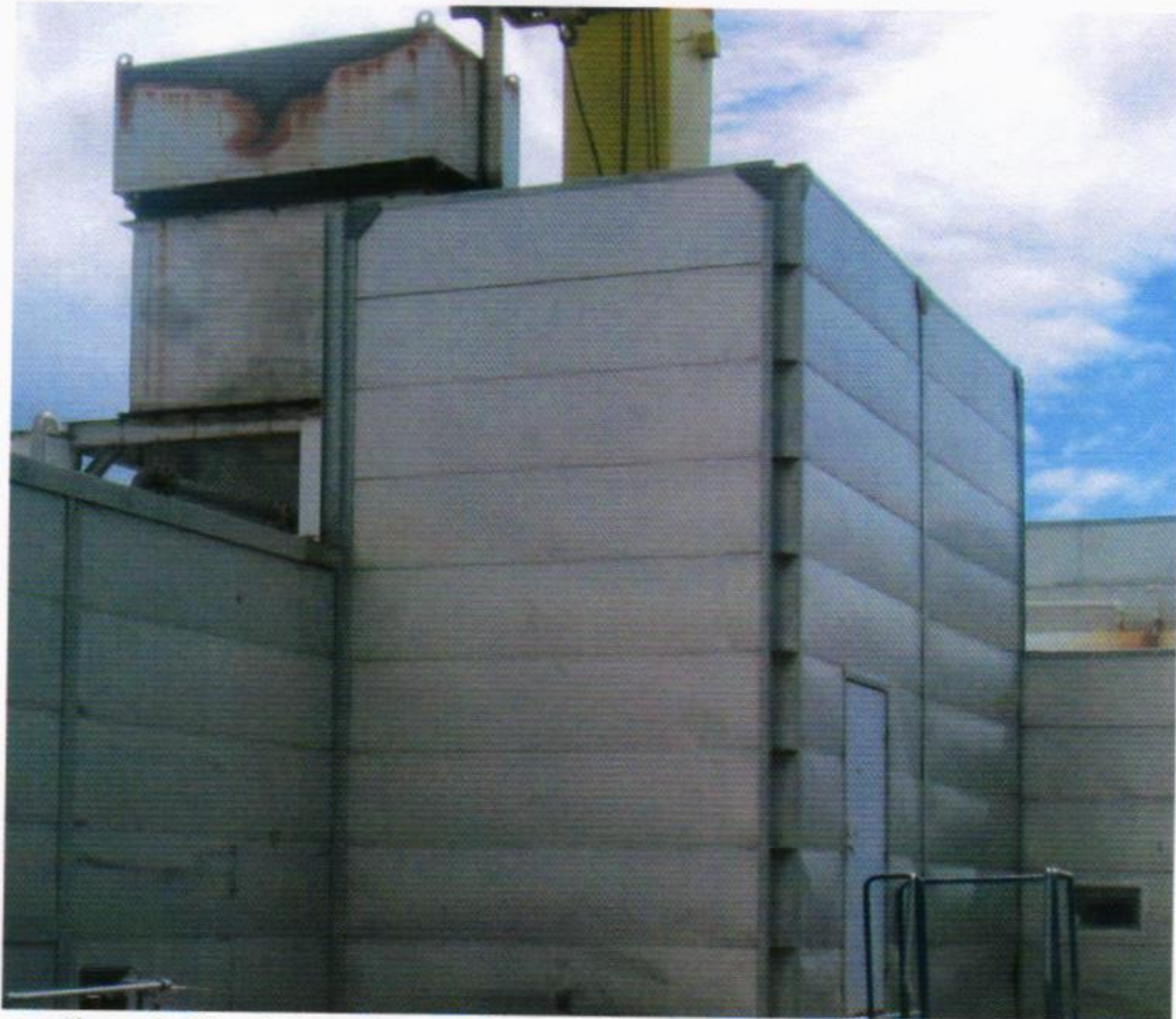
Figura 8: Silenciador del escape de la turbina GE N°5 con panel insonorización.
