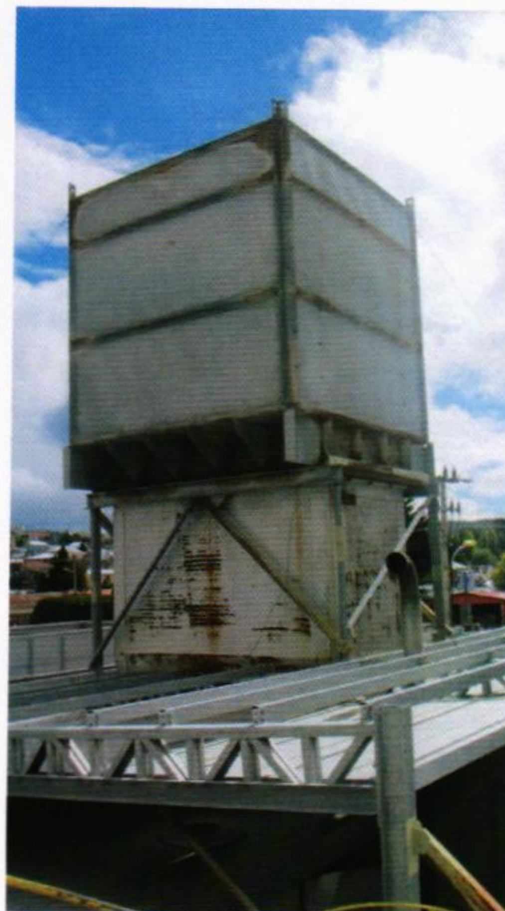
Figura 5: Vista superior del silenciador del escape de la turbina GE Nº4 con panel insonorización.
