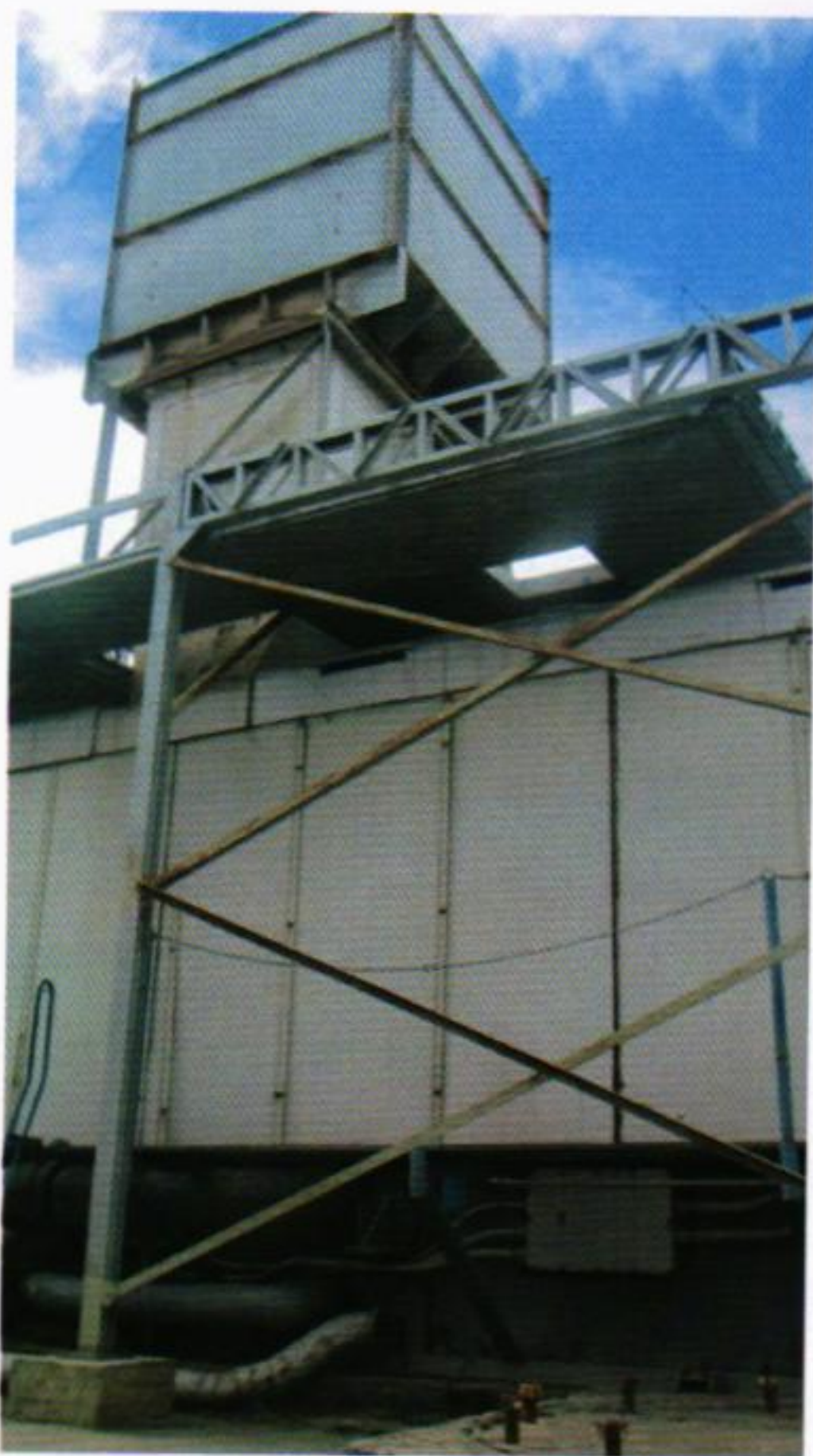
Figura 6: Vista inferior del silenciador del escape de la turbina GE Nº4 con estructura panel insonorización.
