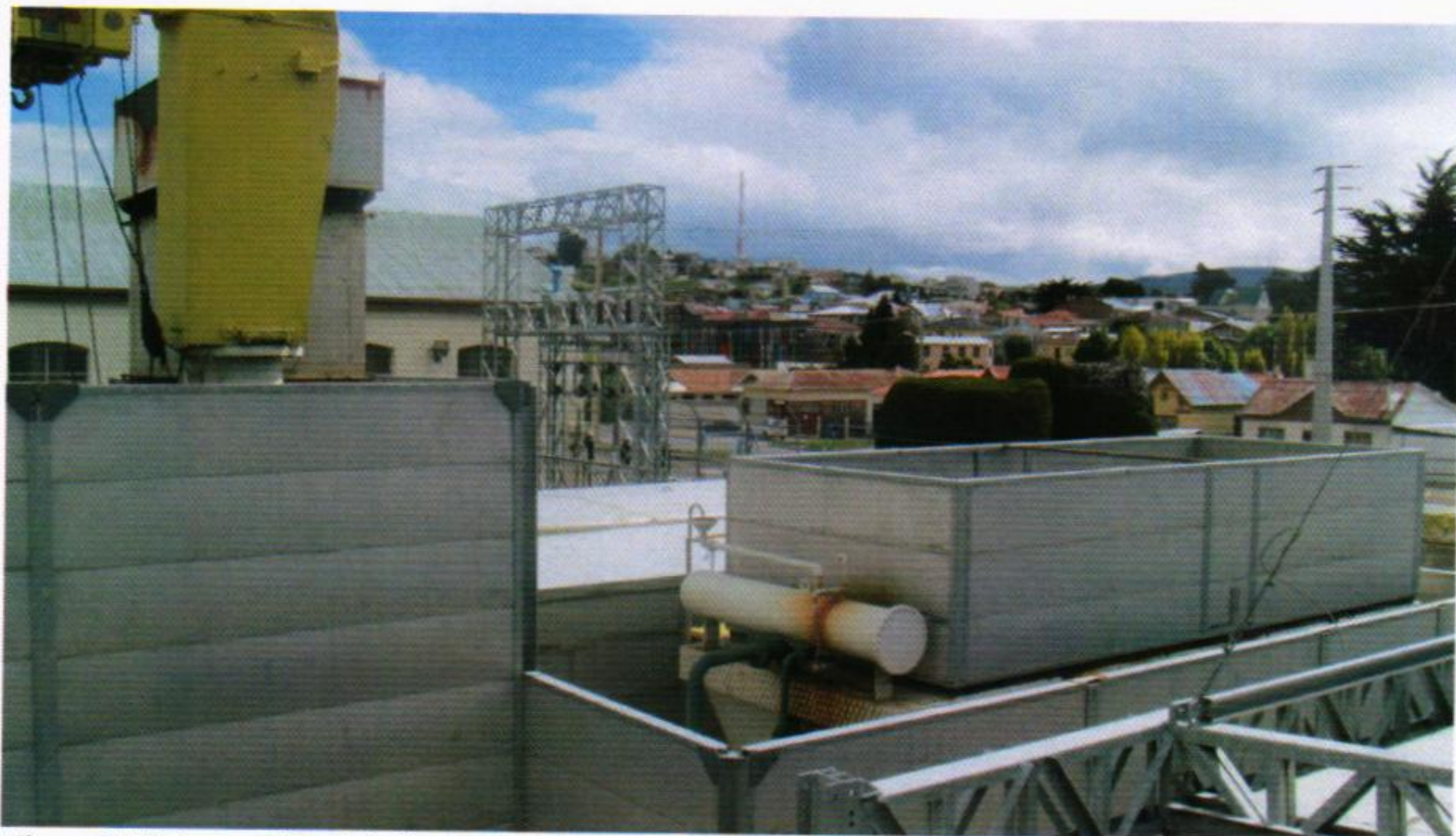
Figura 9: Vista superior del silenciador del escape de la turbina GE N°5 y del enfriador de agua de la turbina, con sus respectivos paneles de insonorización.
