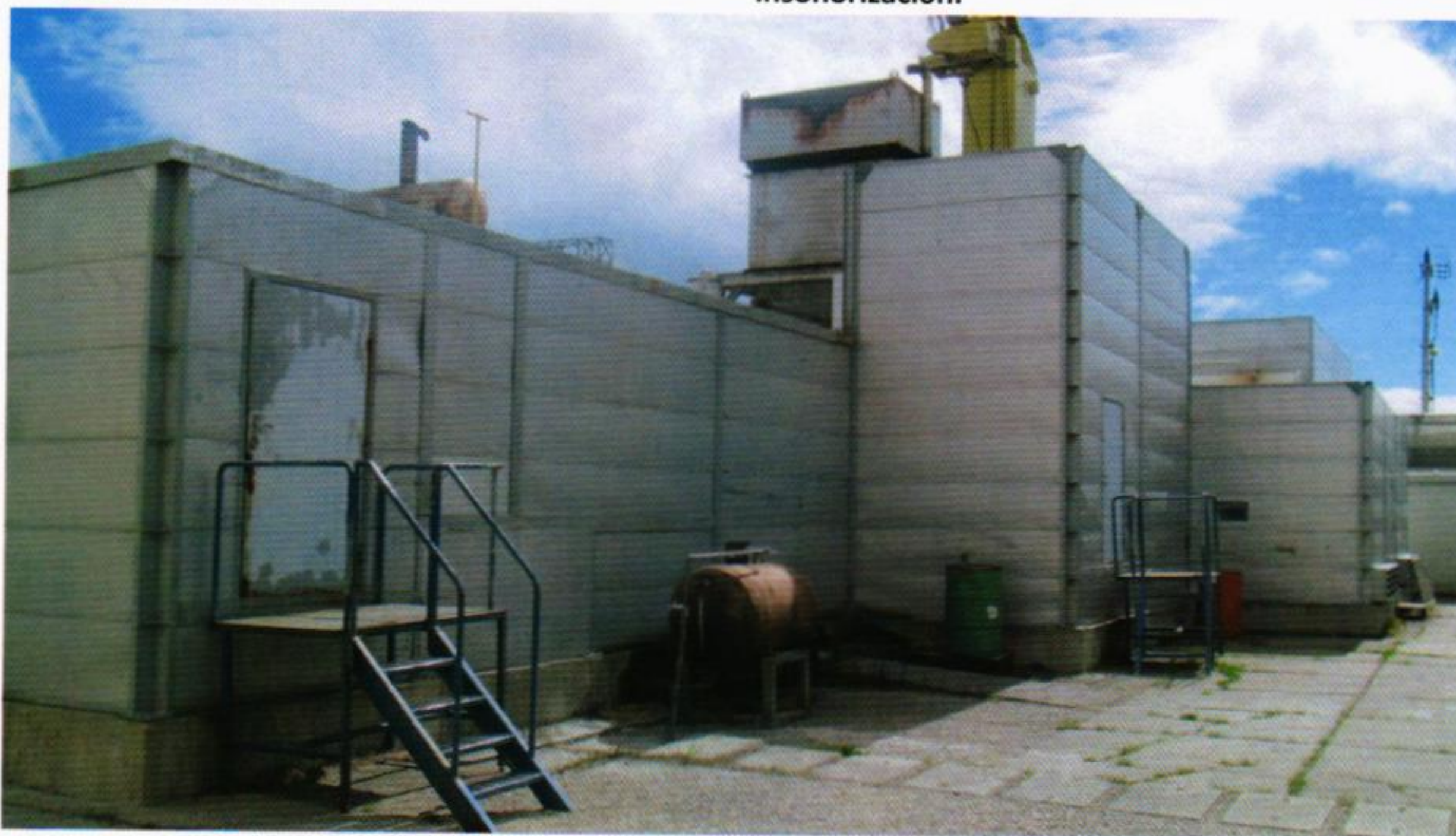
Figura 7: Turbina GE Nº5, elementos periféricos y silenciador del escape de la turbina con panel insonorización.
